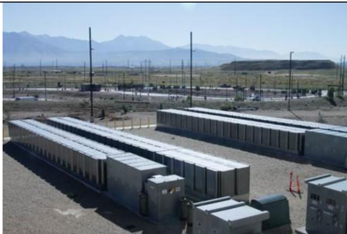
图 16、eBay 使用燃料电池作为数据中心主要能源
