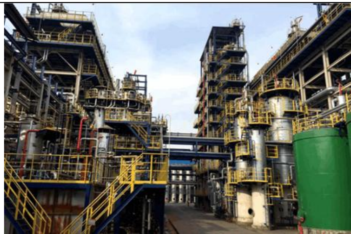
图 26：鹤壁悬浮床加氢项目现场设备图
