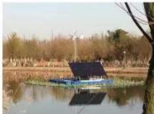
风光互补天然能源曝气系统
