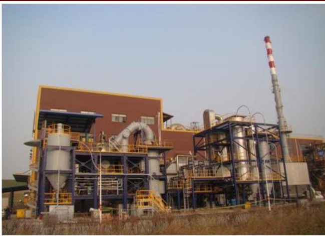
图表 56：上海危废处置中心的焚烧装置
