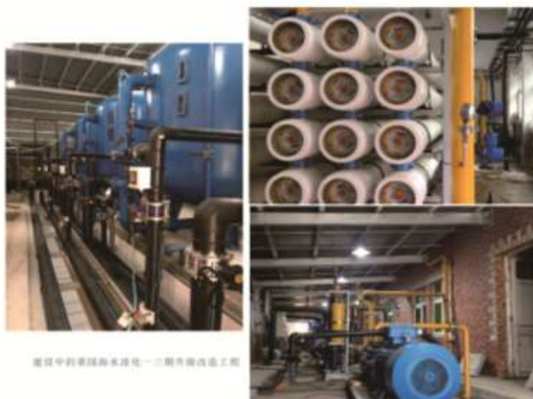
图 5—10 菜园海水淡化一二三期升级改造工程
